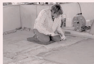
Abb. 23 Einbau des Mosaiks im Frühjahr 2005 an seinem neuen Ort bei der Firma USM.
